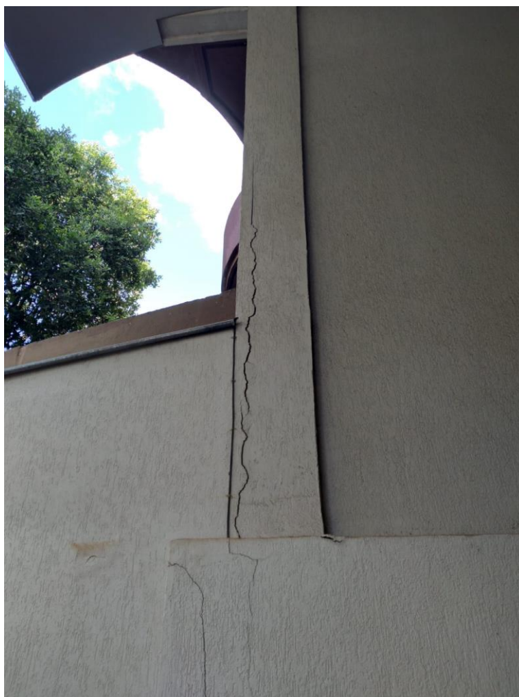
Imagem 9 – Trinca em elemento estrutura próximo a um dos limites do edifício
