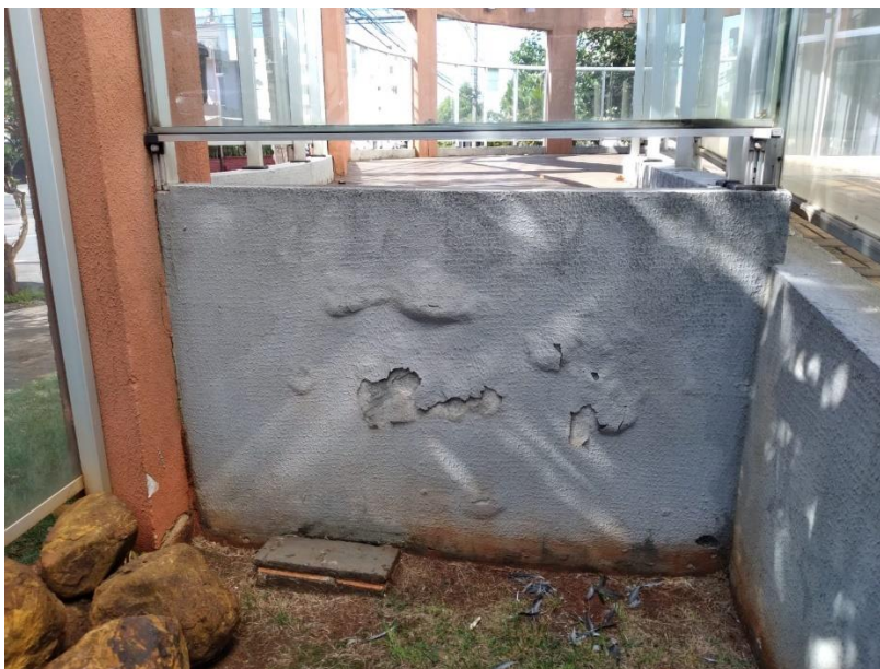
Imagem 8 – Detalhe da área lateral ao lado do deck de entrada com infiltrações e pintura descascada
